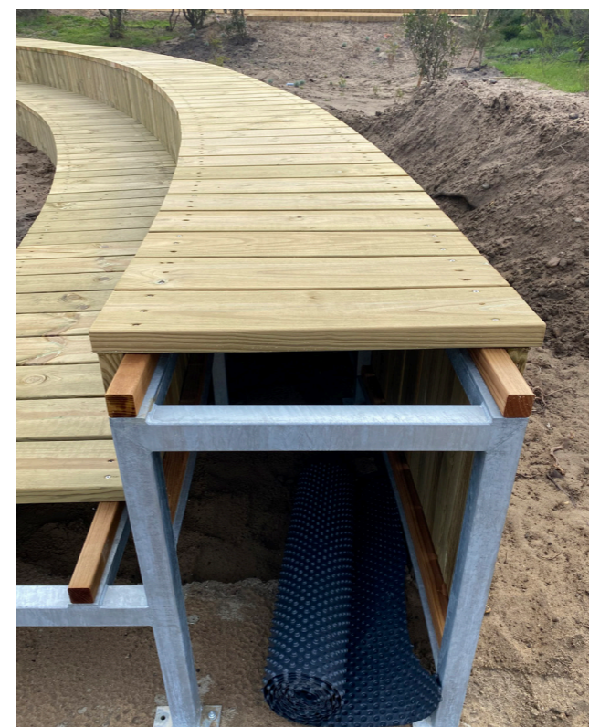
Gradins en structure métallique et platelage bois, Aménagement durable de la lette des Bourdaines, D'une Ville à l'Autre..., Seignosse (40), 2024
